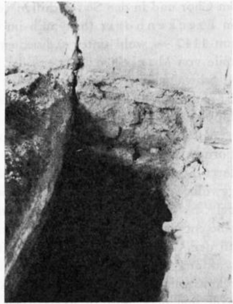
Abb. 2 Fuge zwischen Südmauer (links) und Turm-Ostmauer (rechts)
