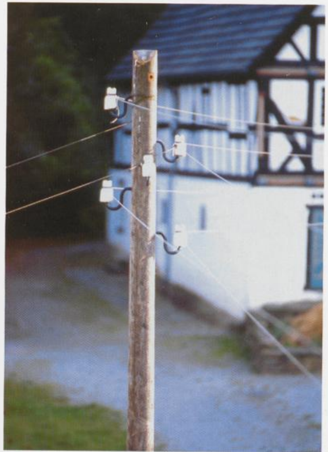
Abb. 14 Strom für das Sauerländer Dorf: Rekonstruierte Freileitung im Freilichtmuseum
