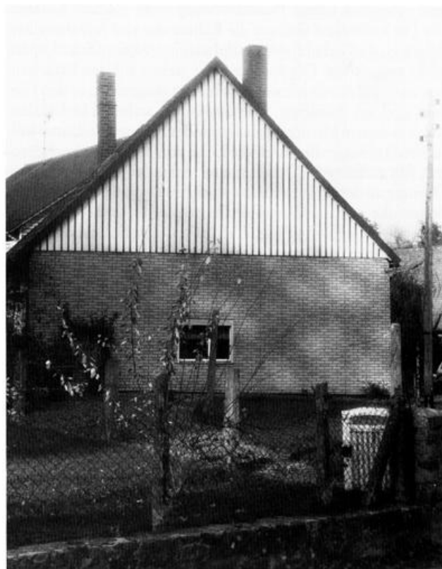
Abb. 77: Haus Klöpping in Höntrup. Südgiebel. Fachwerk mit Bitumenplatten verkleidet (1979).
