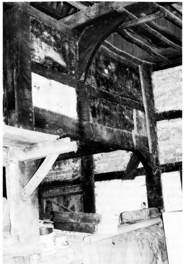
Abb. 26: Leibzucht. Frühere Küchenlucht mit starker Verrußung.
